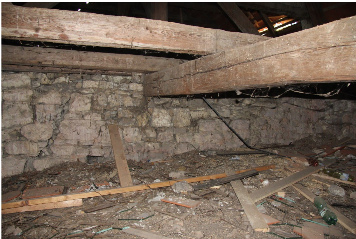
Detail severního zdiva nad klenbou presbytáře v pohledu od jihu. Patrný je kontrast mezi červeně zbarvenými opukovými kameny prošlými požárem a světlou opukou z barokní opravy. Foto: Marta Pavlíková 2018.
