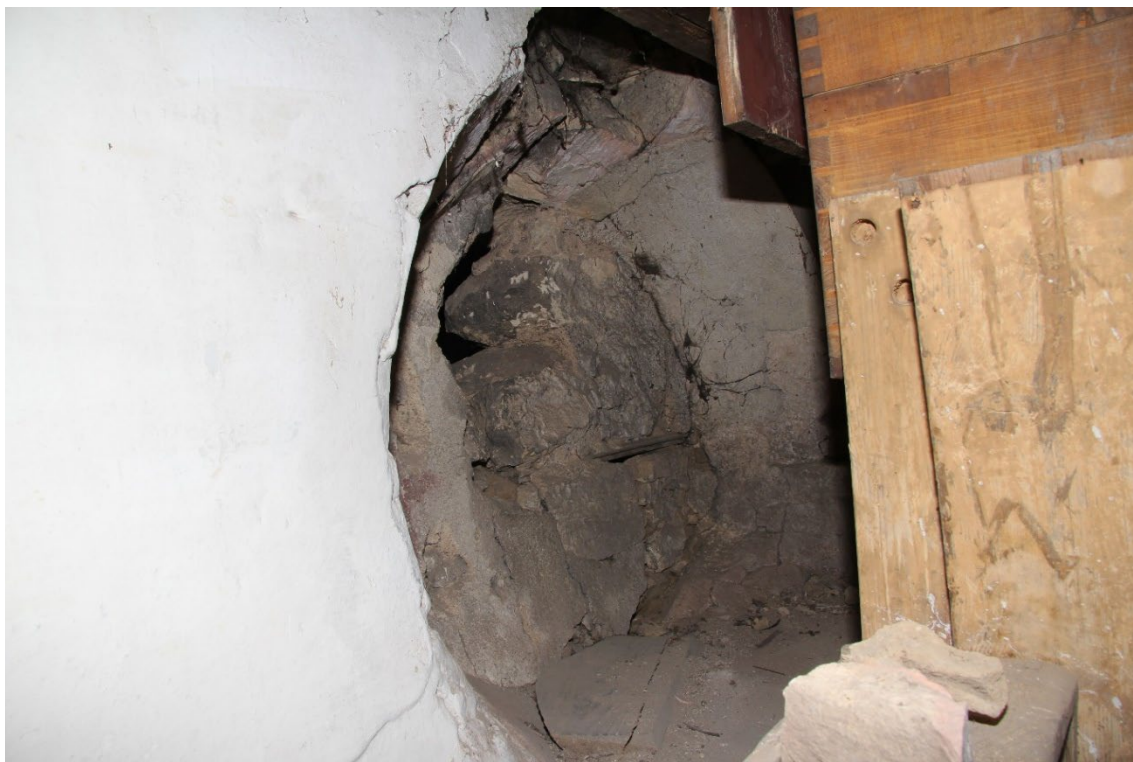
Pohled od jihovýchodu na zazděný středověký kruhový otvor v ose západní zdi lodi, který se nachází za varhanními měchy. Foto: Jaroslav Skopec 2020.
