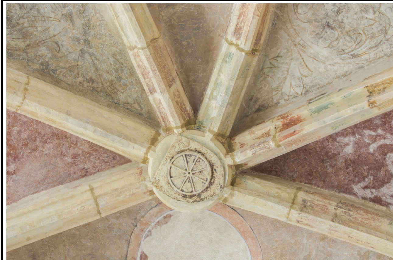
Detail východního svorníku klenby presbytáře. Foto: Marta Pavlíková 2020.
